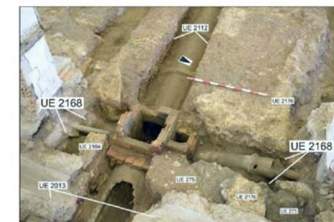
Figura 13. Zanja UE 2168 con tuberías que desembocan en el alcantarillado general UE 2112 y que están conectadas con las bajantes alojadas en los pilares.
